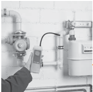
Обнаружение утечки газа детектором testo 316-1
