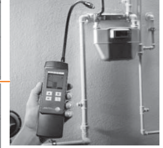
Локализация утечек дымовых газов с помощью детектора testo 316-2
