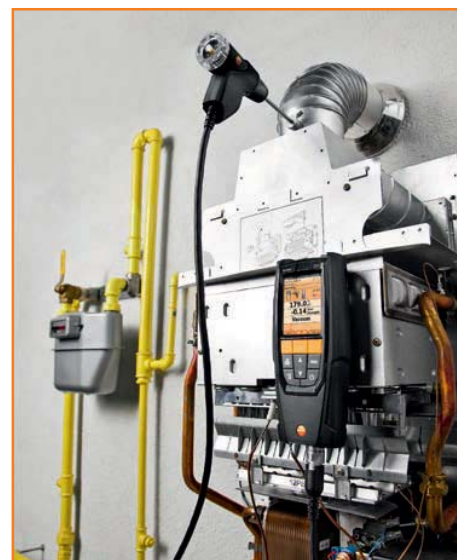
Измерение тяги дымовых газов с помощью testo 320.
