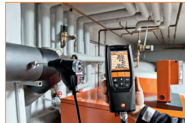
Рис. 12: Измерение температуры воздуха, идущего на горение
